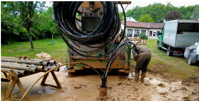
© Commune de Saint-Benoît - Test de réponse thermique (TRT)
